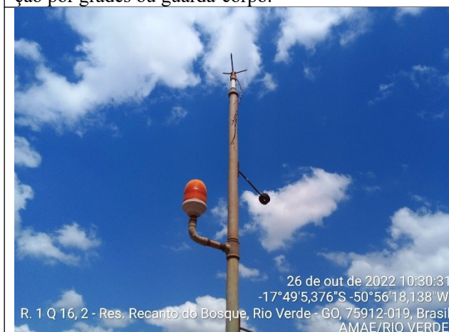
Autor: Autor: AMAE Descrição: Sinalização noturna e para-raios sem fixação de aterramento.
