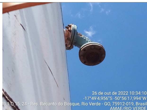
Autor: Autor: AMAE Descrição: Tubo extravasor com proteção contra entrada de poeira.
