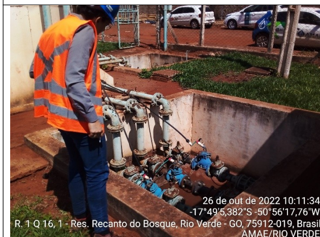
Autor: Autor: AMAE Descrição: Caixas de inspeção e passagem sem proteção por grades ou guarda-corpo.
